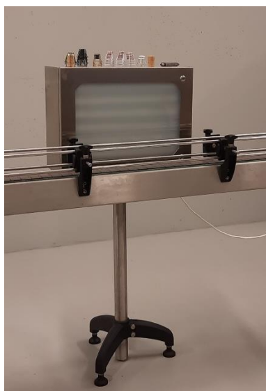
13. ábra: Nagyteljesítményű megvilágító lámpa egy borászati üzem palackozó vonalán (Forrás: saját szerkesztés)
